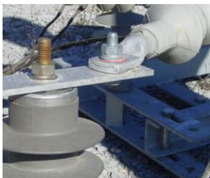
Slika 16: Primer neustreznega spoja pri priklopu kabla na ločilnik (Al/Cu KČ-cevni, z obročkom ni za zunanjo montažo)
