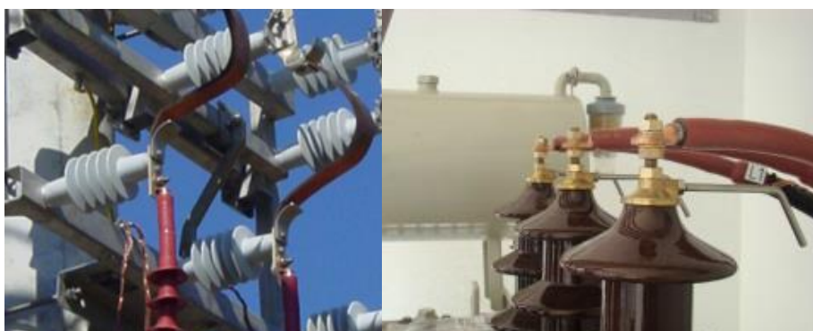
Slika 17: Ustresen priklop z Al-Cu kovanimi kabel čevlji (levo), spoj na VN priključkih TR (kovani Cu -čevlji - desno)
