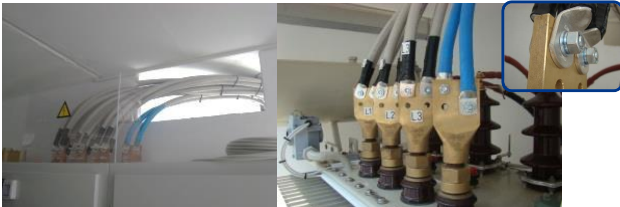
Slika 18: Ustrezen spoj na NN priključke NN omare (levo), ustrezen spoj na NN priključke na TR s Cu KČ (desno).
