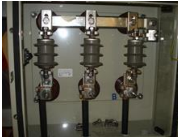
Slika 39: Omarica z odvodniki prenapetosti na kabelskem zaslonu
