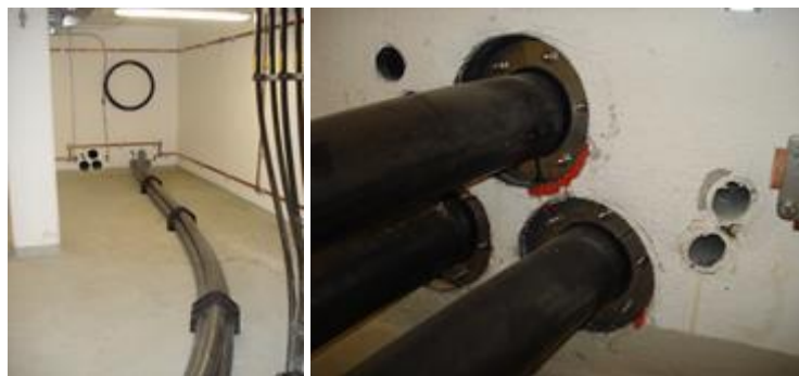
Slika 40: Vodenje VN kablov v kabelskem prostoru (levo) in kabelska uvodnica na prehodu v kabelski prostor (desno)
