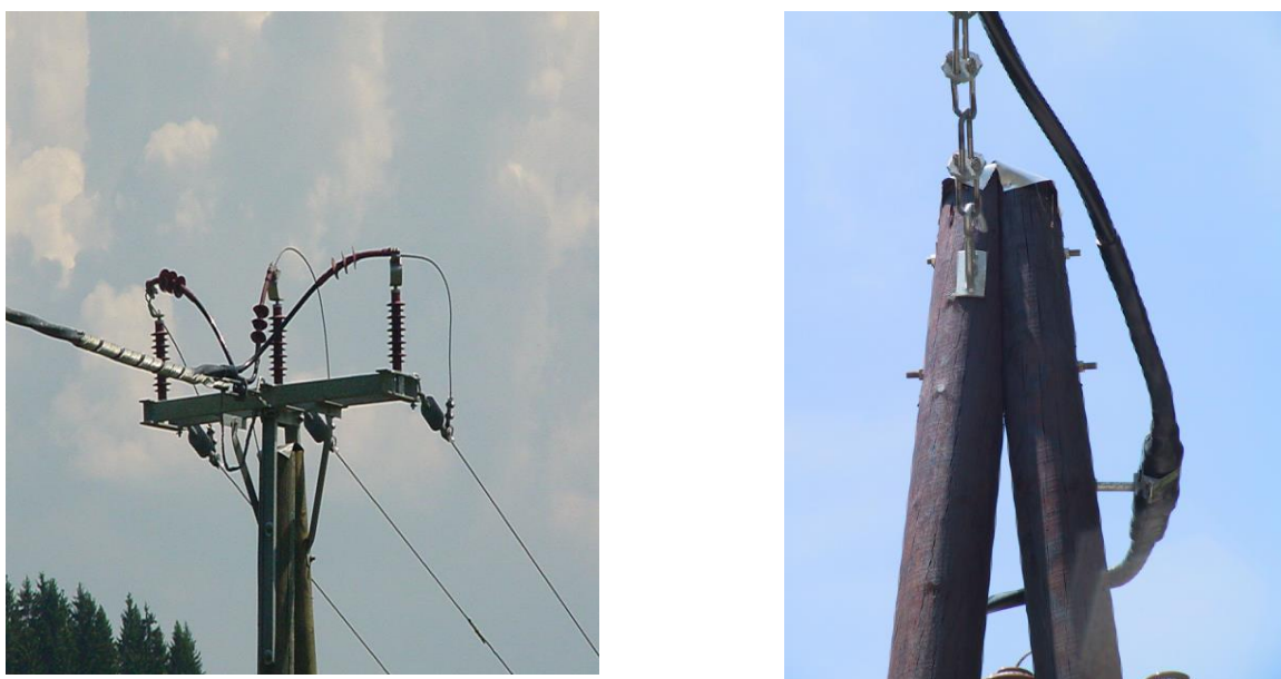
Slika 21: Prehod kabla v GV z odvodniki prenapetosti (levo) in izvedba kabske spojke na drogu (desno)
