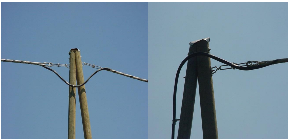
Slika 20: Primer izvedbe kabske spojke na razbremenilnem oporišču
