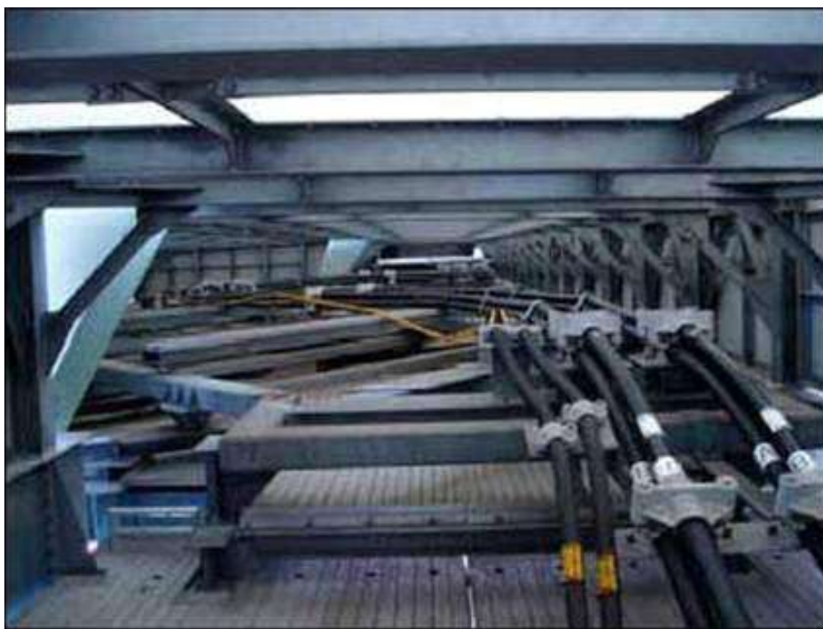
Slika 60: Pantografska namestitve VN XLPE kablov na dolgem visečem mostu.
