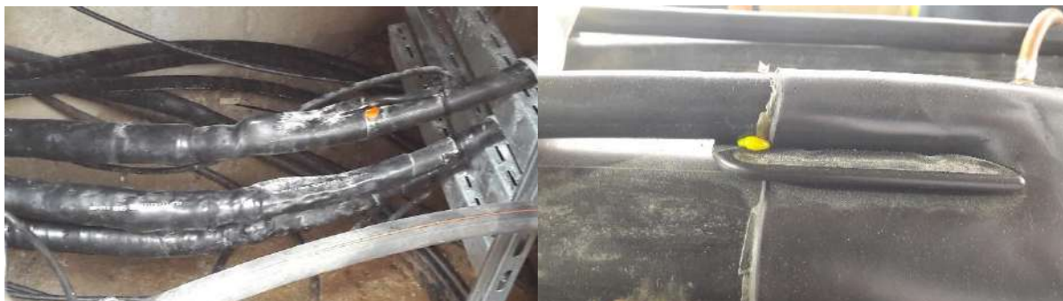
Slika 6: Prikaz izvedbe navzkrižne povezave kovinskih zaslonov na priključnem SN kablovodu za tovarno KRKA v Novem Mestu z namenskimi kabelskimi spojkami.
