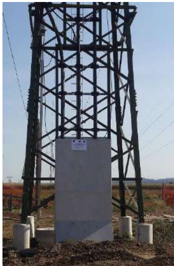
Slika 12: Zaščita kablov pri prehodu iz zemlje na SM pred mehanskimi poškodbami
