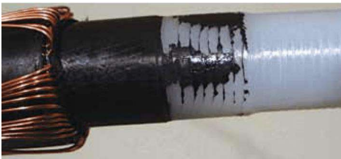
Slika 34: Pri površno odstranjenem polprevodnem sloju se pri namestitvi izolacijskega tulca napaka kompenzira
