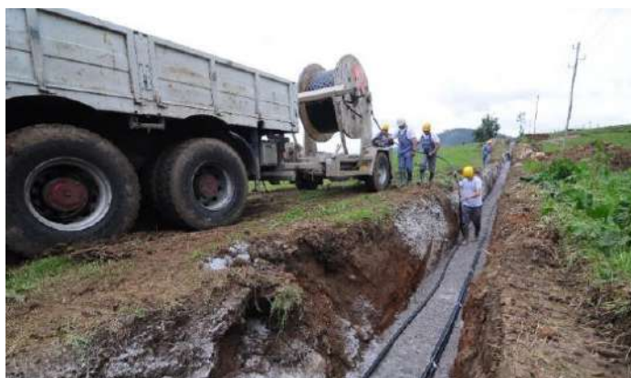
Slika 16: Poenostavljeno polaganje SN kablov direktno v kabelski jarek
