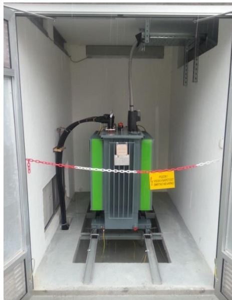
Slika 5: Pogled razporeditve opreme v Tr prostoru
